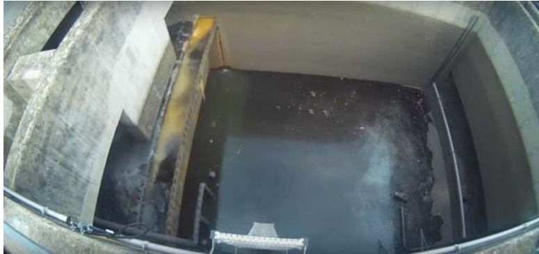
Vue d'un des bassins pour lequel le ratio longueur sur largeur est trop faible ( L/B = 1.5 ).
