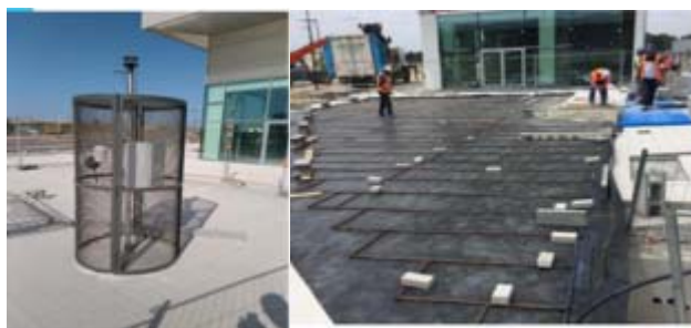
Système d'automatisation et de mesure de la performance, site de Toulouse (source : 2EI)
