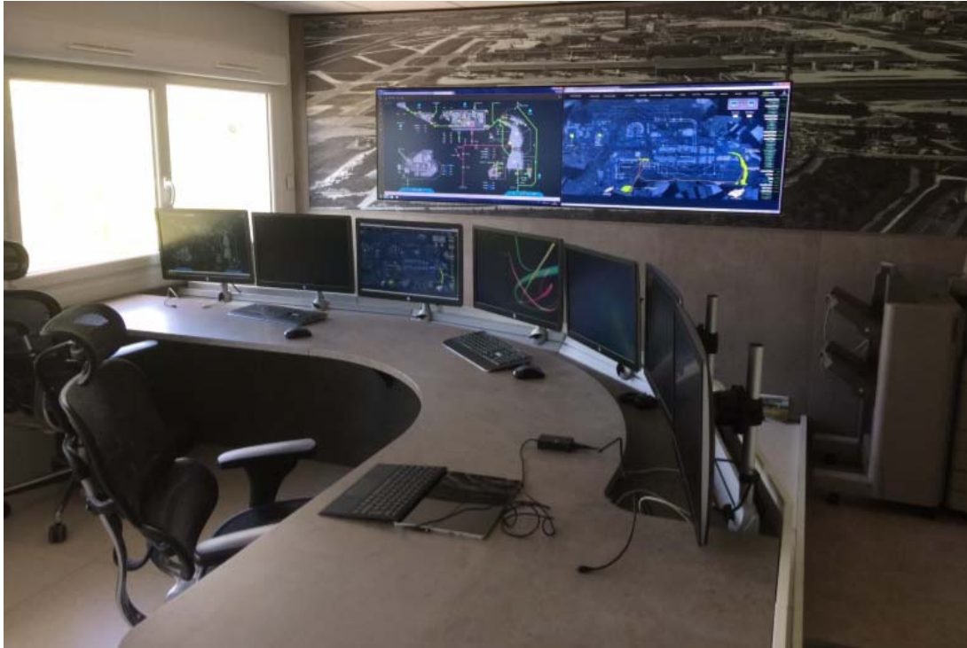
Salle de contrôle sur la plateforme aéroportuaire Paris CDG
